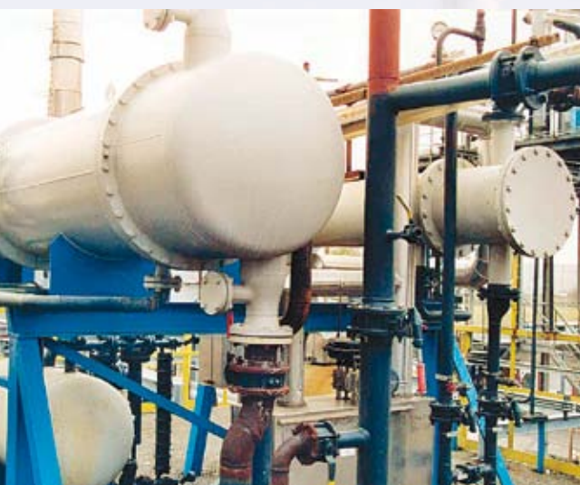
Refroidissement de méthanol
