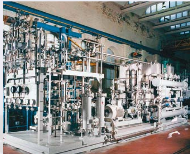
Refroidissement d'air comprimé
